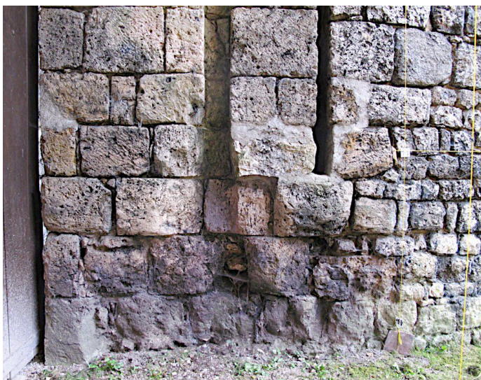
Fig. F 04 - Porte du château, base de la rainure de herse ouest. Traces d'incendie (rubéfaction) (Photo : Michel Piechaczyk).
