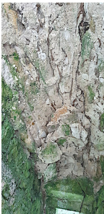
Fig. L 36 - Voûtement de la baie Z1.03 avec négatifs de couchis (Photo : Florian Renucci, ADM).
